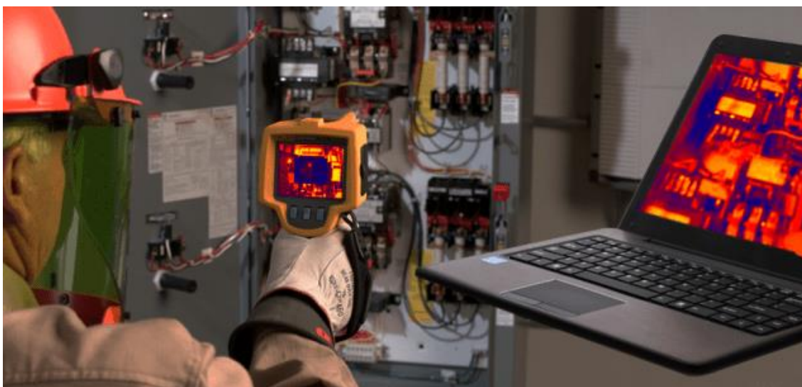
Рисунок 20. Пример проведения тепловизионного контроля электрошкафа
