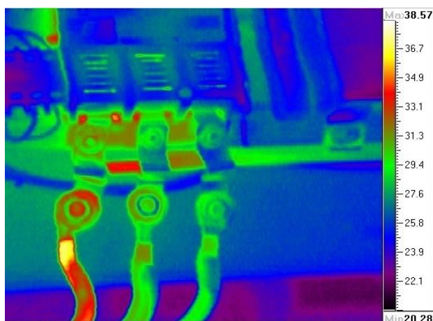
Рисунок 21. Пример термограммы контактных соединений с температурной шкалой
